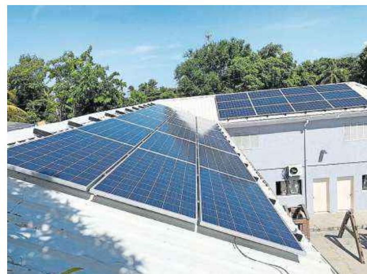
Die neue Solaranlage auf dem Dach des Waisenheims.
